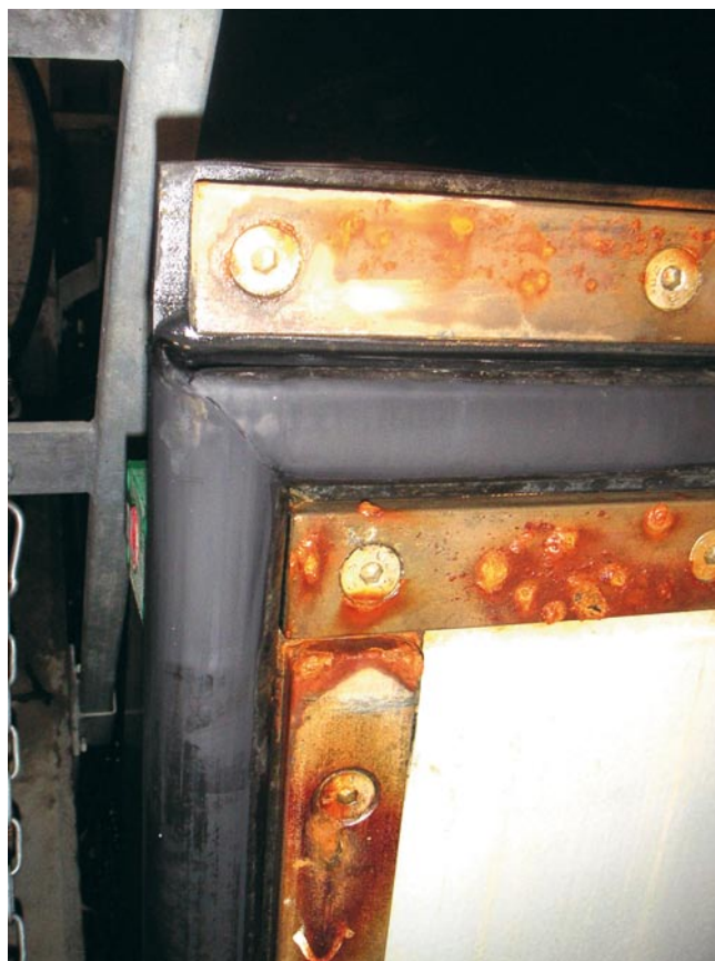
Bild 5 Korrosion an einem Segmentschütz mit starker Pustelbildung.
