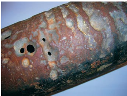
Bild 4 Korrosion durch Stromeinwirkung an einem duktilen Gussrohr.
