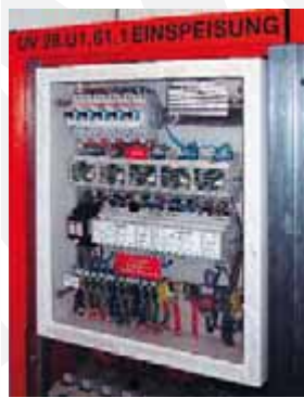
Dezentrale-LPS Unterstation eingebaut in Hauptverteilung
