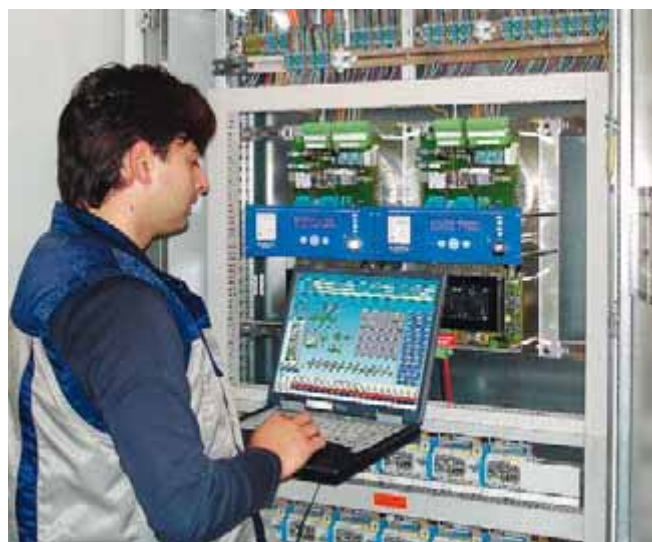
Notlichtsystem-Wartung durch qualifizierten Systemtechniker
